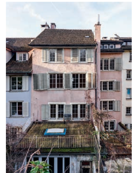
Hofansicht: Dies ist das aktuelle Bild der Immobilie vom Lindenhof her gesehen. Der schlechte Zustand der Substanz ist deutlich erkennbar.
